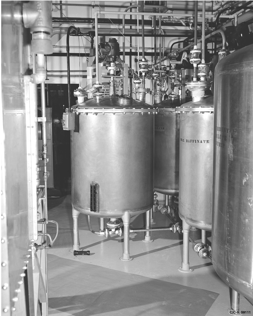
Рисунок 12. Емкость, в которой в 1958 году на площадке в Лос-Аламосе произошла авария с возникновением СЦР.
